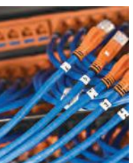
Conexión de routers y servidores
